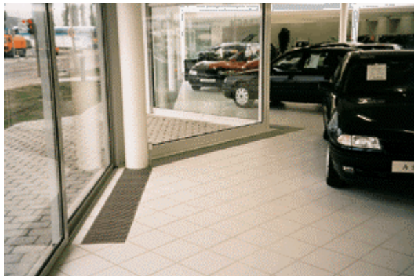
Bild 3: Konvektoren bieten in der Unterfluranordnung freien Blick durchs (Schau-)Fenster.
